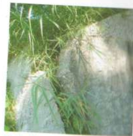
Pukotina na spoljašnjem zidu
