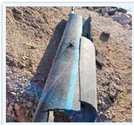
Slika 4. Izgled napukle cijevi, sa podužnom pukotinom
