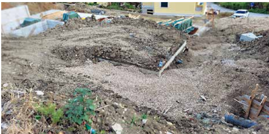
Изглед градилиштя након санације цјевовода, какво чека насћавак у септембру кад се насћавља грађевинска сезона
